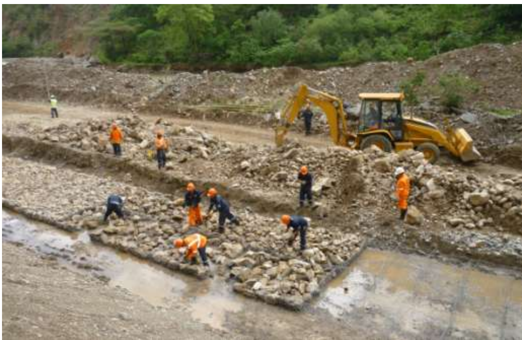
Llenado de canastas tipo CFB (Reforzadas) en la protección de talud en el km 22+500 al 22+550
