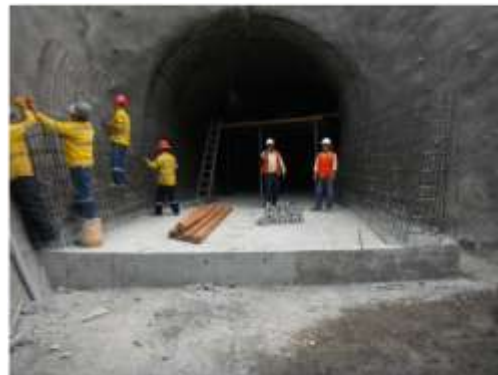
PISO DEL EMBOQUILLE AL 100% E INICIO DE TRABAJOS EN EL FALSO TUNEL
